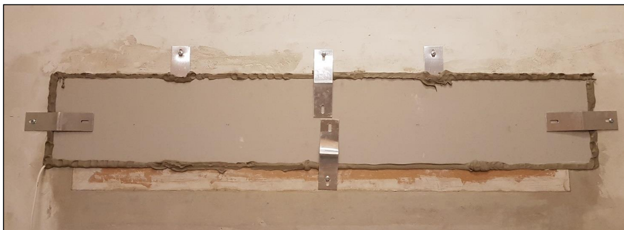
Coffre sans entrée d'air vu du côté réception
